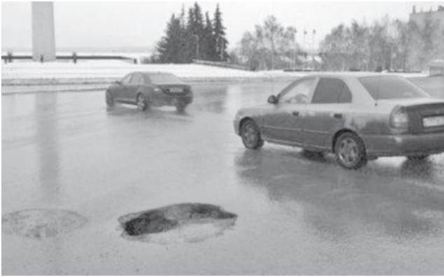
Фото большой дорожной ямы при повороте с улицы Минаева на улицу Гончарова в среду в официальном аккаунте в «Твиттере» опубликовала администрация города, призвав автомобилистов быть осторожнее. Причиной провала асфальта стала просадка грунта. Неделию назад «Водоканал» устранял здесь утечку.
